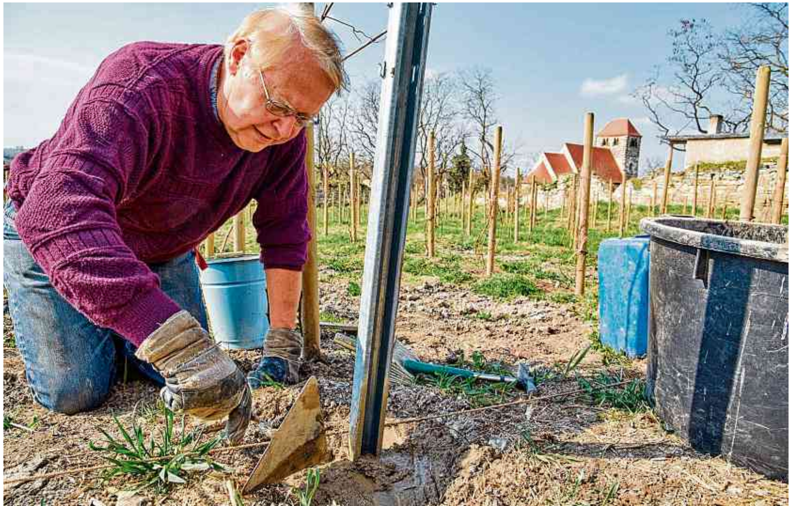
Der ehemalige Hochschulpräsident Dieter Orzessek mauert derzeit die Pfosten für Rankhilfen ein.
