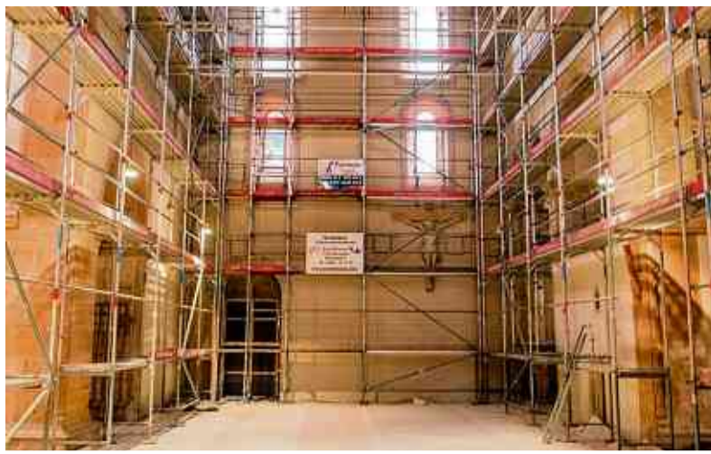
Im östlichen Querschiff stehen noch die Gerüste. Sie sollen bald fallen, wenn die dortigen Instandsetzungsarbeiten beendet sind.
