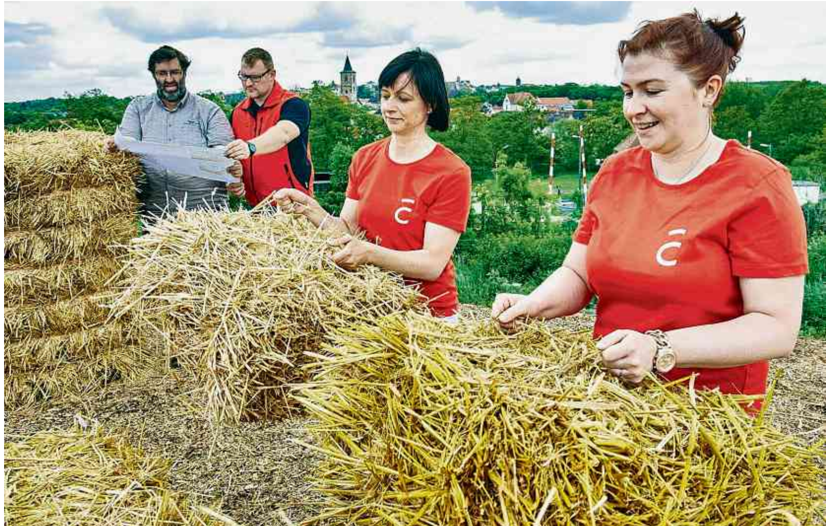
Mitarbeiter der Hochschule Anhalt bauen aus Strohballen einen Windschutz für die provisorische Aussichtsplattform auf dem Weinberg.
